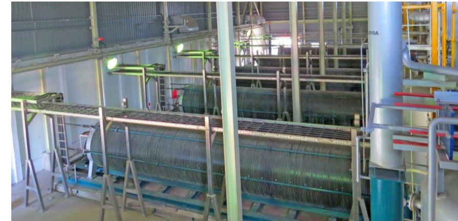
Image: Nel Asa, Alkaline electrolyser, Malaysia, 2019
